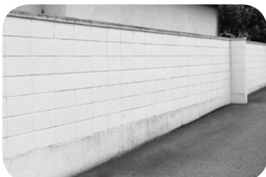
改修工事が急がれる危ない ブロック塀
