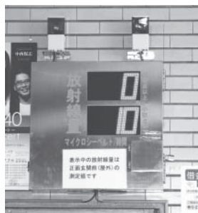
寄付により本庁舎ロビーに設置された放射線量の表示装置
