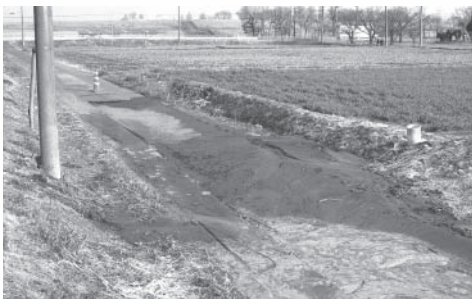
液状化による被害の状況(震災直後)
