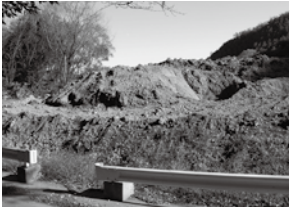
土砂が積み上げられ、危険な西山田地内の現場
