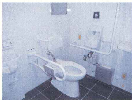
多機能トイレの設置（H27）
