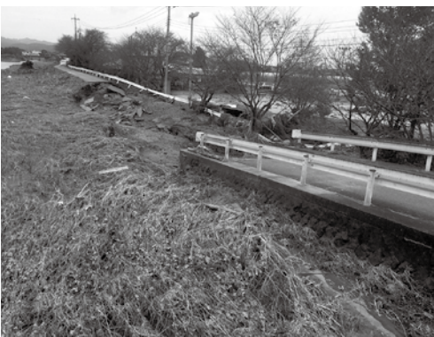
さくら保育園裏の永野川堤防決壊の様子
