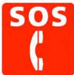
非常電話 Emergency telephone
