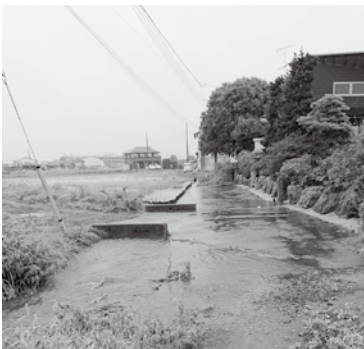
溢水状態となる 沼和田町地内の排水路
