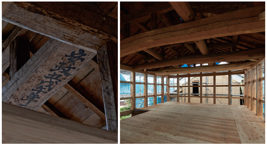
創建当時の梁に書かれた墨書。次の改修時に年代特定ができるよう田村さんも梁の仕口に改修年度を書き残した。
