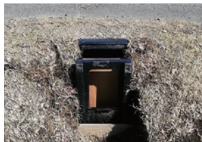
田んぼダムの排水調整柵
