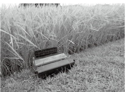
吹上東部地区の調整ます
