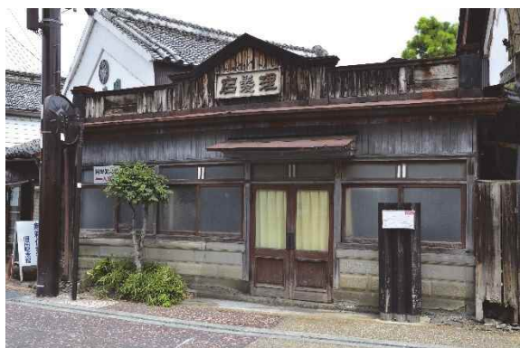
洋風店舗 修理前
