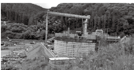
大芦川から南摩ダムへ水を補給する吐出口
