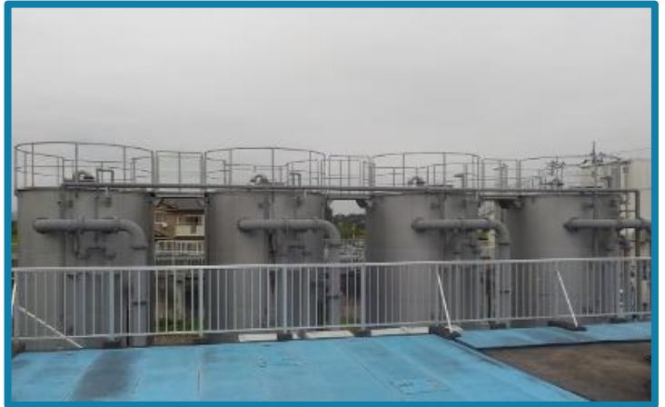
ふじおかじょうすいじょう せいぶつかっせいたん か せつび 藤岡浄水場 生物活性炭ろ過設備
