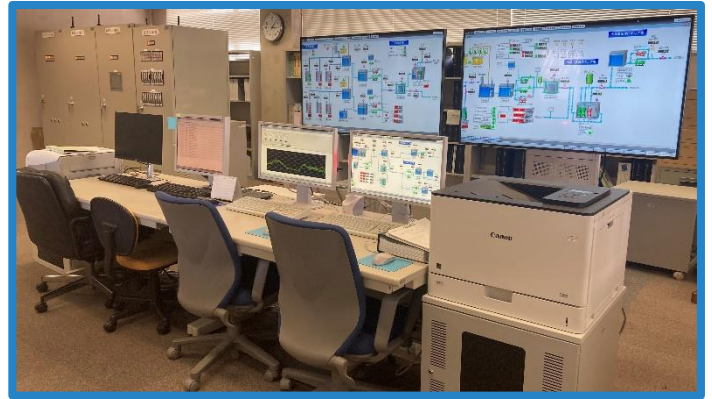
そのべじょうすいじょう ちゅうおうかんししつ 菌部浄水場 中央監視室
