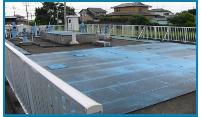
ふじおかじょうすいじょう ぎょうしゅうちんでん ち 藤岡浄水場 凝集沈殿池
