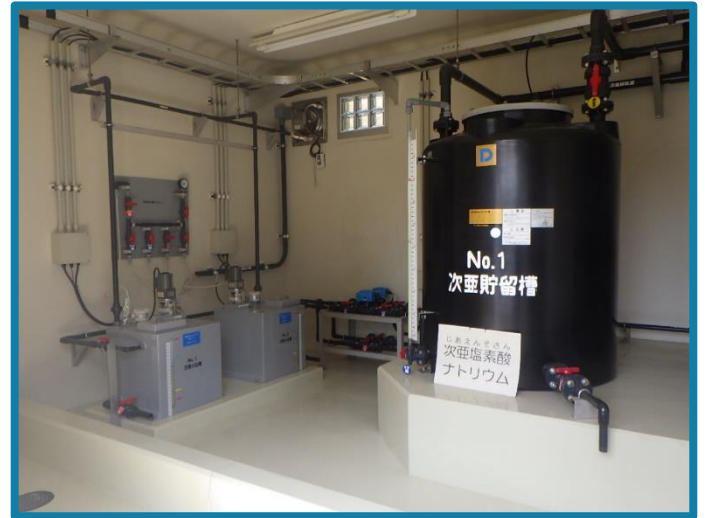
そのべじょうすいじょう めっきんしつ 菌部浄水場 滅菌室
