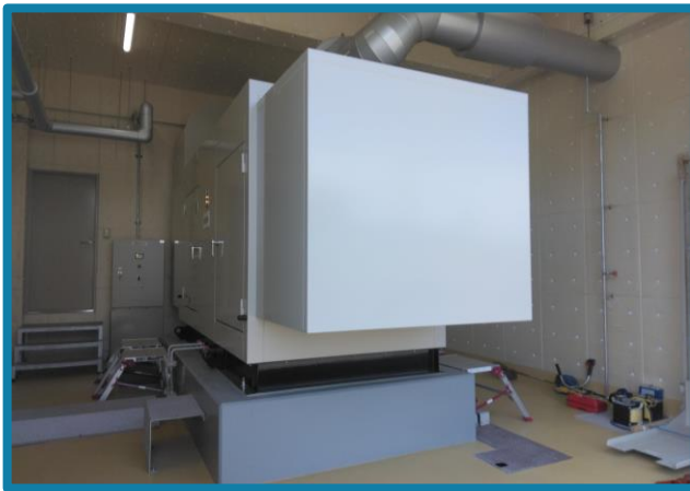
そのべじょうすいじょう ひじょうようはつでんせつび 菌部浄水場 非常用発電設備
