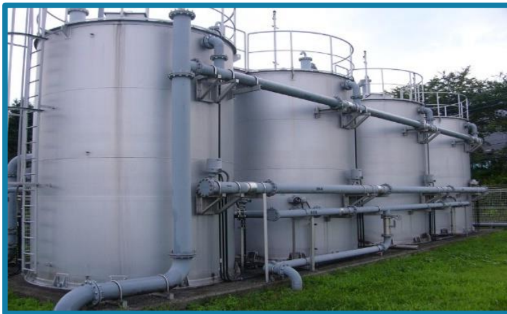
ふじおかじょうすいじょう きゅうそく か せつび 藤岡浄水場 急速ろ過設備
