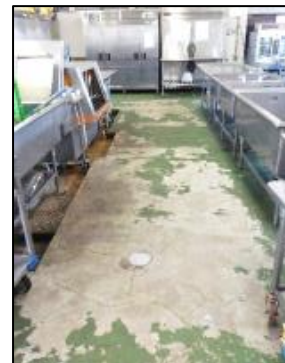
(国府北小) 調理室の床が老朽化している。
