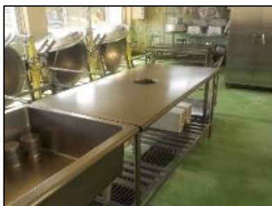
(栃木第三小) 作業台がドライシステムに対応していない。
