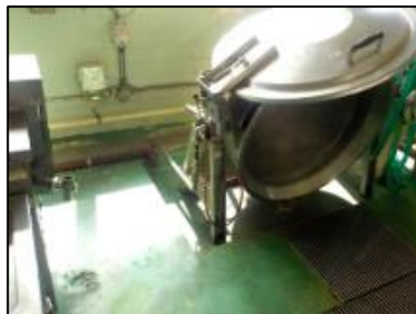
(栃木第三小) 調理室の床が老朽化している。
