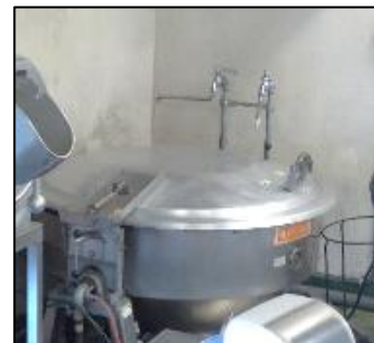
(国府北小) 回転釜がドライシステムに対応していない。
