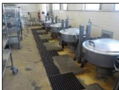
(大宮北小) 回転釜がドライシステムに対応していない。
