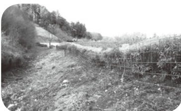
被害に遭った公園に設置された防護柵
