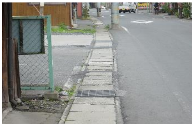
嘉右衛門町伝建地区内の道路の様子 白線が薄くなっており、側溝蓋も破損があり歩きづらい
