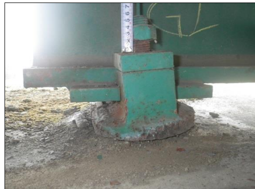
写真2 健全度Ⅲの事例
