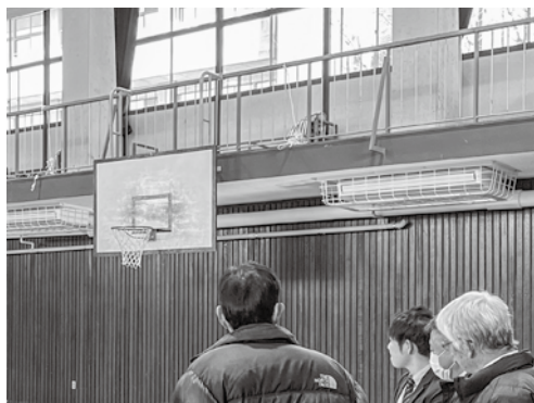
小山第一小学校体育館のエアコン▶
