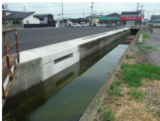
(地下貯留施設（流入口）)
