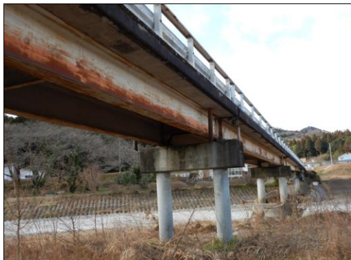
写真1 健全度Ⅱの事例
