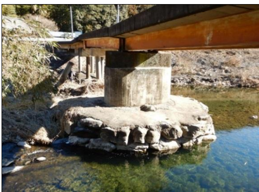
写真3 健全度Ⅳの事例
