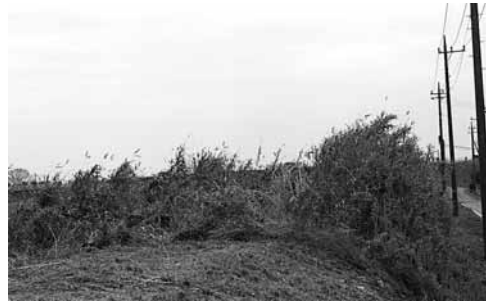
早急な整備が望まれる榎本地内の永野川堤防
