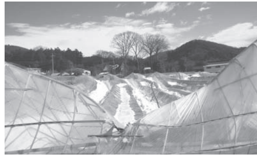
大雪により倒壊したハウス(今年2月)
