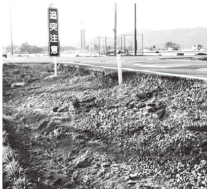
舗装崩れの危険箇所
