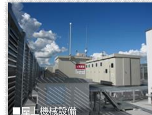
■屋上機械設備
