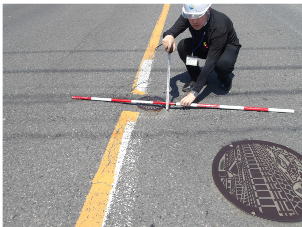
【公共汚水ます周辺の沈下】
