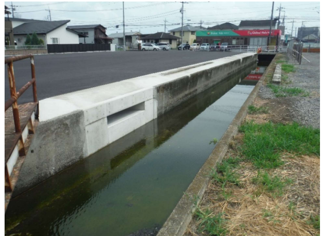
⑥清水川地下貯留施設
