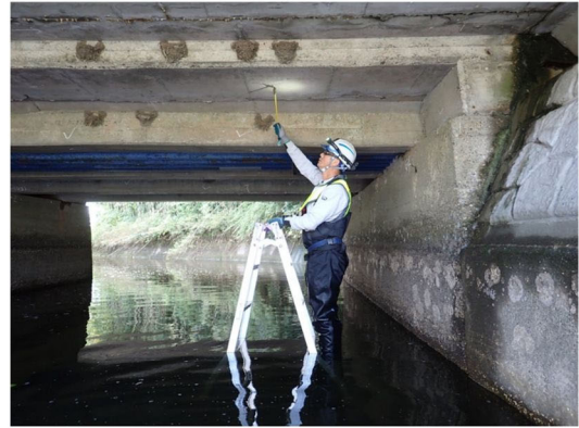
定期点検で継続的に状態把握・予防的補修
