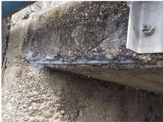
健全度Ⅱの事例
