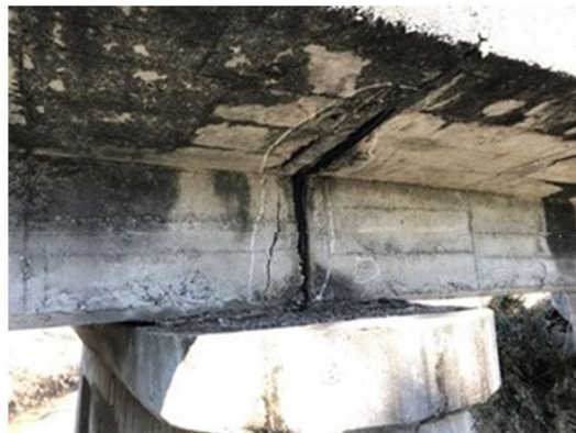
健全度Ⅲの事例
