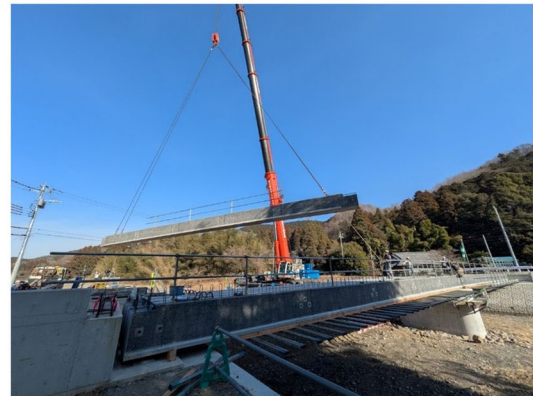
抜本的対策としての架替更新
