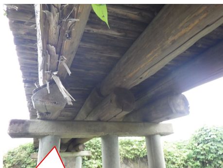
主桁が木製であり、抜本的補修が困難
