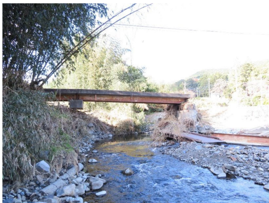
健全度Ⅳの事例
