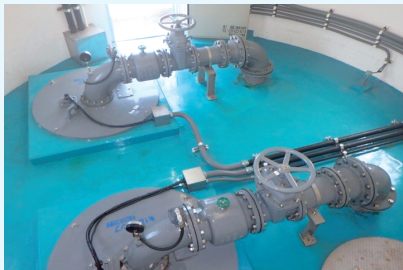
菌部第1水源の取水ポンプ
