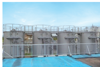
生物活性炭ろ過設備
