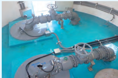
菌部第1水源の取水ポンプ
