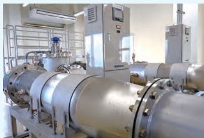
菌部浄水場の紫外線照射装置 (R8.3完成)
