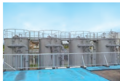
生物活性炭ろ過設備
